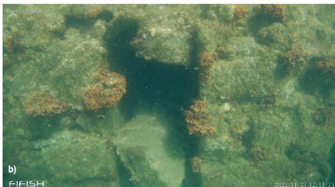
Θραύση και κατάρρευση στοιχείων δόμου βάσης (Χ.Θ. 0+376,6)
